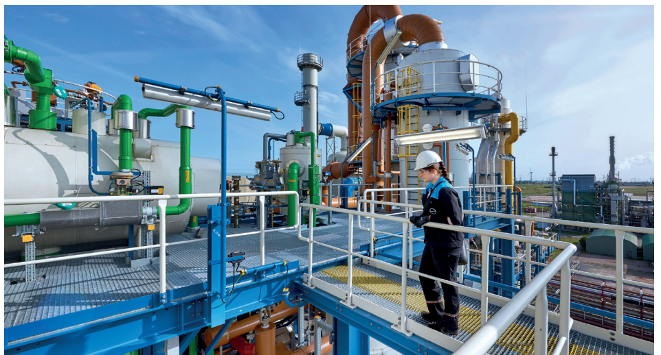
Chemikantin Isabell Witthohn bei einem Rundgang durch die MDI-2-Anlage. Foto: Covestro AG
